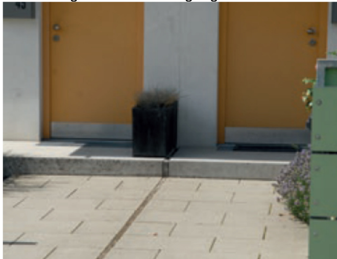
Aufkantung am Gebäudezugang
