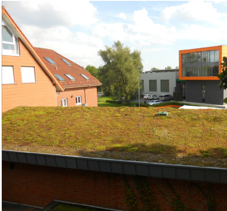
Dachbegrünung zur Kühlung darunter liegender Räume
