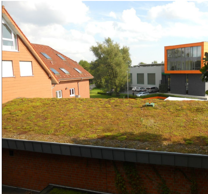
Dachbegrünung zur Kühlung darunter liegender Räume
