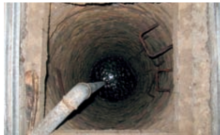
Eisenteile in Schachtbrunnen
