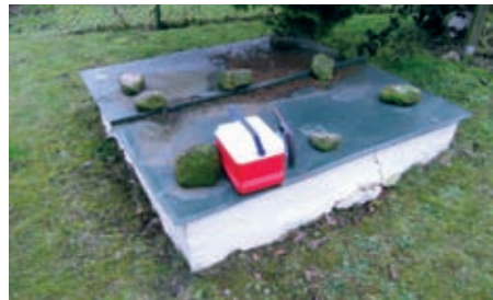
Undichte, mangelhafte Abdeckung
