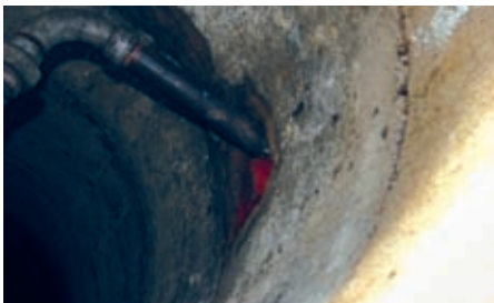
Nicht ausreichend abgedichtete Rohrdurchführung
