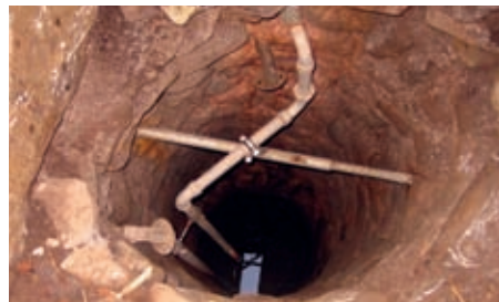
Korrodierte Rohre, starke Eisenoxidausfällungen
