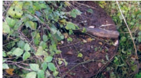
Korrodierte, nicht tagwasserdichte Abdeckung
