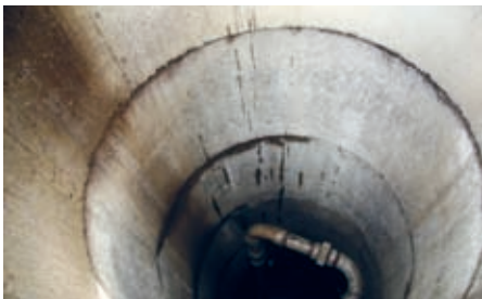
Feuchtigkeitseintritt zwischen Schachtringen
