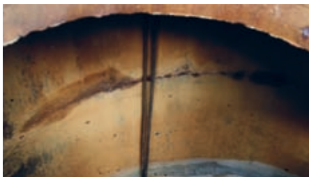
Feuchtigkeitseintritt zwischen Schachtringen
