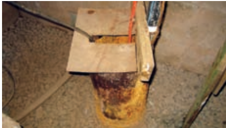
Mangelhafte Abdeckung Brunnenrohr
