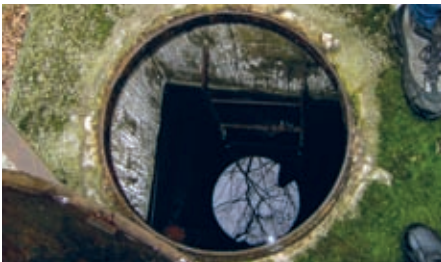
Einwuchs von Pflanzenwurzeln in den Quellschacht
