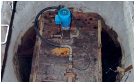
Stark verschmutzte, offene Holzabdeckung
