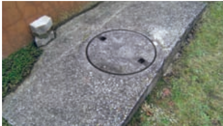
Risse in der Betoneinfassung führen zu Undichtigkeiten
