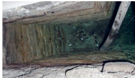
Quellschacht mit baulichen Mängeln
