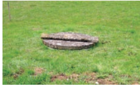
Betondeckel nicht tagwasserdicht
